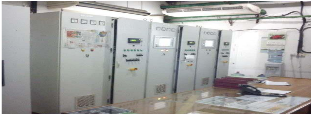
MWM (Deutz) control room
